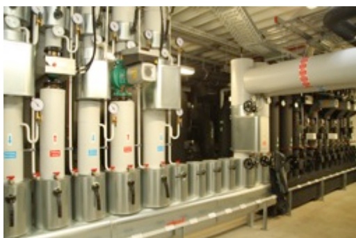
Eine hochmoderne Anlage sorgt für die Verteilung von Druckluft, Wärme und Kälte
