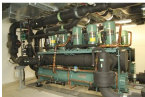
Die Kältemaschine ist der Teil der energieeffizienten Klimatechnik, die G-TEC für Pilz geplant hat
