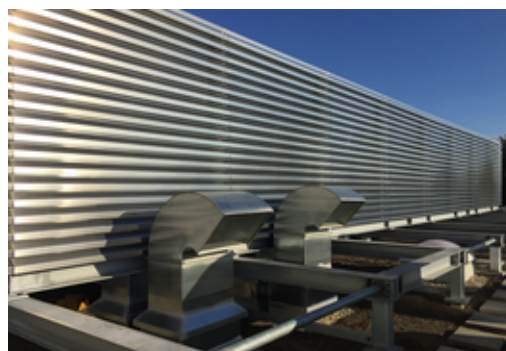
Auf dem Dach der Hauptgebäudes befindet sich eine komplexe Lüftungsanlage
