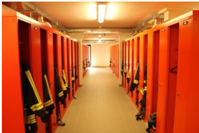
Die Spinde für die Einsatzkleidung sind fest an die Abluftanlage angeschlossen
